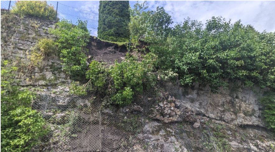
Blick vom Dach der Fa. Schwaighofer GmbH auf die Absturzstelle
