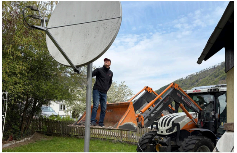
Servicearbeiten bei der TV Signalaufbereitung
