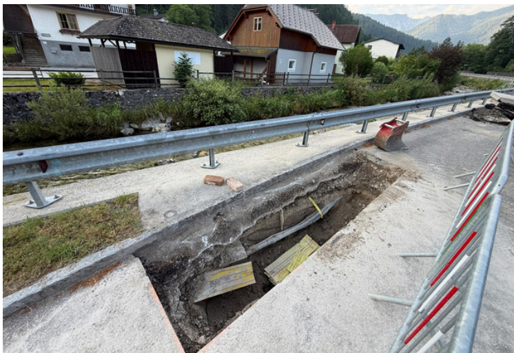
Kabelschaden Wiener Netze
