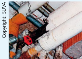
Asbesthaltiger Mörtel zur Rohrisolierung
