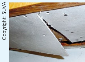
Asbesthaltige Leicht- bauplatten (Lüftungen, Schaltschrankausklei- dungen)
