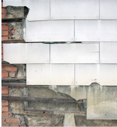
Teilweise gebrochene Fassadenplatten
