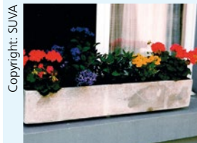
Blumenkisten aus Asbestzement
