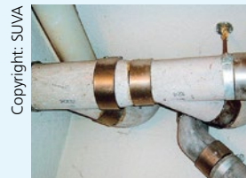
Rohrleitungen aus Asbestzement
