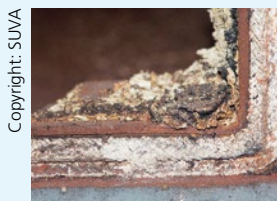
Dichtungsschnüre aus reinem Asbest in Brenn- und Ofenkammern
