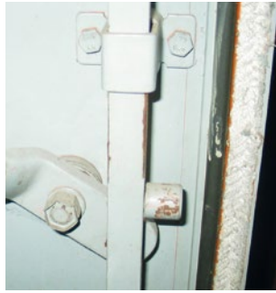
Brandschutztür mit asbesthaltigem Dichtungsband
