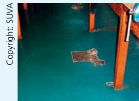
Asbesthaltige Boden- beläge
