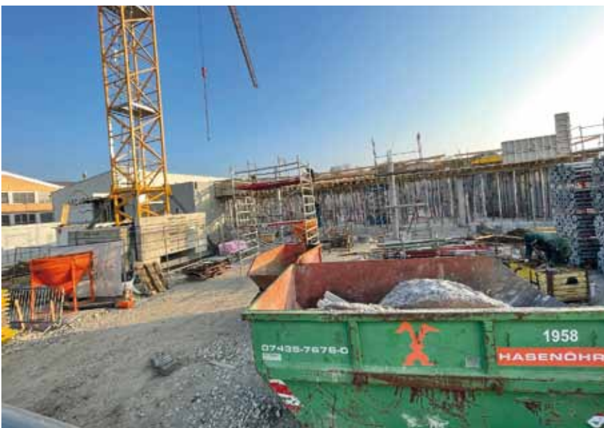
Foto vom 18.2.2025: Baustellenbilder vom neuen Nahversorgerzentrum weiter. Hier ist man schon mit den Vorbereitungen für die erste Geschosdecke über dem zukünftigen ADEG Markt beschäftigt.
