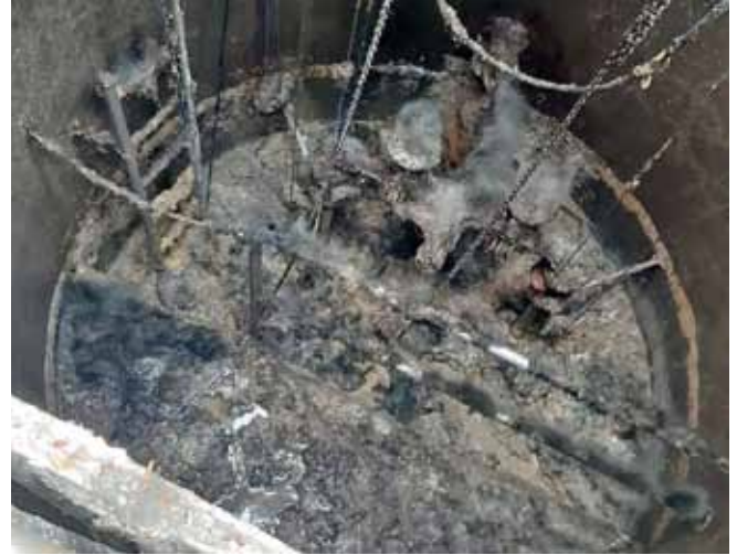
Foto: So können Küchenabfälle, Fette und Öle die Pumpen der Kanalpumpwerke oder auch der Kläranlage verstopfen!
