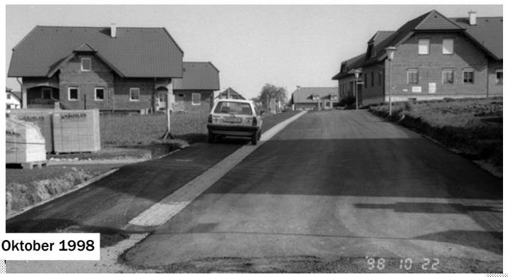
Ende Oktober wurde ein Teil der Aufschließungsstraße in der "Edelsteinsiedlung" asphaltiert. Links: Smaragdstraße Rechts: Rubinstraße
