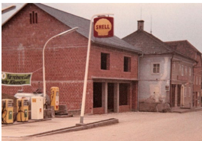
Rohbau Teil 1 des Kaufhauses Brunner ca. 1967 (verkauft wurde daneben in der ehem. Helm's Handlung)
