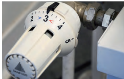
Heizung zurückdrehen spart bares Geld
