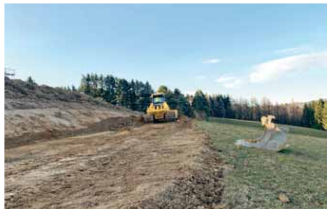
© zVg Foto: Regenwasserversickerung Holzhausen III.
