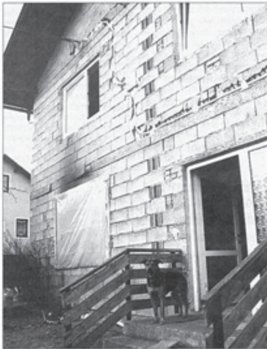
In diesem Haus, das noch gar nicht fertiggestellt ist, brach der Brand aus
