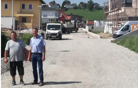
Bgm. Dietl mit dem Baupolier Herr Schütz von der Firma Lang & Menhofer während der Arbeiten in der Sportplatzstraße.
