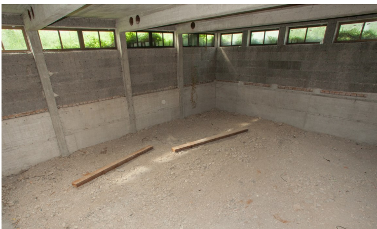
Foto: Der 40 Jahre alte Rohbau der Volksschule, der zu einem Fitness- und Bewegungszentrum ausgebaut wird, das allen zeitgemäßen Anforderungen entspricht
