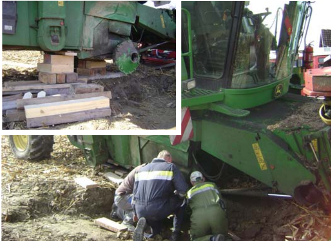
Hohe Lasten und schwere Zugänglichkeit - eine klassische Anforderung für den Einsatz von Hebekissen
