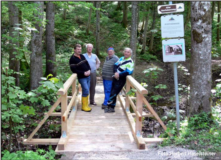
Dank der Mithilfe von Herbert Leichtfried, Josef Auer, Josef Frühwald und Karl Mayrhofer (nicht im Bild: Johann Käfer und Leopold Großberger) wurden die Anlagen am Weg im Schlosshain saniert und erneuert!
