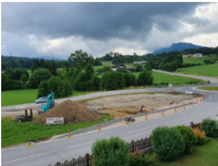
Der Baufortschritt an der Busbucht und die Park & Ride Anlage ist schon deutlich zu sehen.
