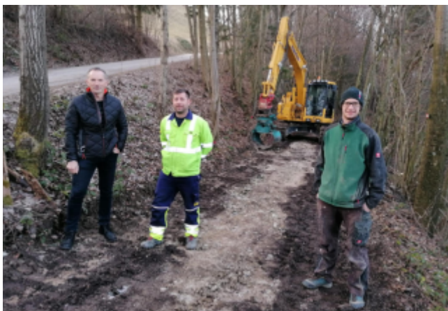
Die Zufahrtsstraße zur Senderbaustelle im Besitz der Familie Daurer „Haubenberg“ wurde neu geschottert, damit die schweren Fahrzeuge problemlos die Baustelle erreichen können
