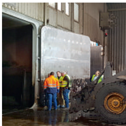
Blick in einen der Fermenter = Gaserzeuger
