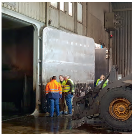
Blick in einen der Fermenter = Gaserzeuger
