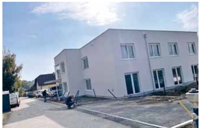
Foto: Die Baustelle für das betreute Wohnen für beeinträchtigte Menschen schreitet zügig voran.
