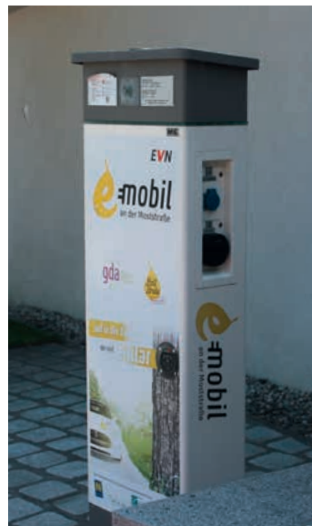
Ab Juni erfolgt die Umstellung bei der E-Ladestation am Marktplatz.
