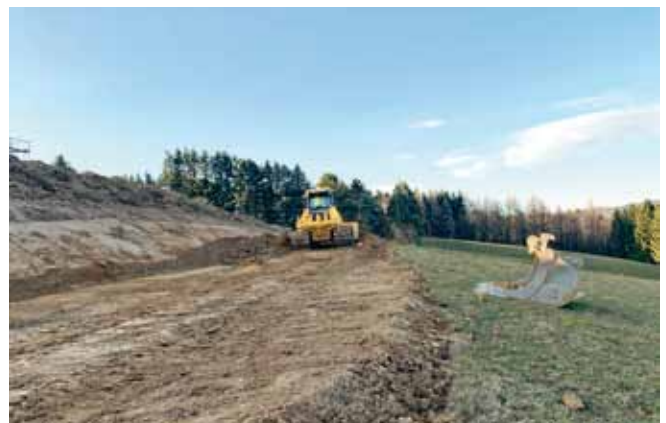
© zVg Foto: Regenwasserversickerung Holzhausen III.
