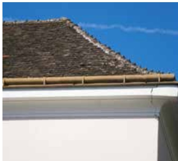
Foto Markus Eder: Blick auf das ca. 65 Jahre alte schadhafte Dach des Pfarrzentrums
