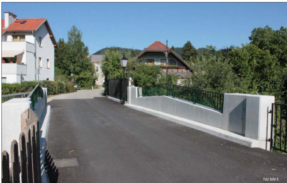
Die sanierte Schönauerbrücke wurde am 25. September von hw. Pfarrer Franz Sinhuber gesegnet. Bgm. Fahrnberger konnte das Objekt offiziell seiner Bestimmung übergeben.
