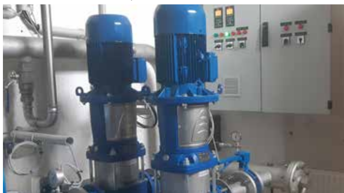
Neue Drucksteigerungsanlage (Schule)
