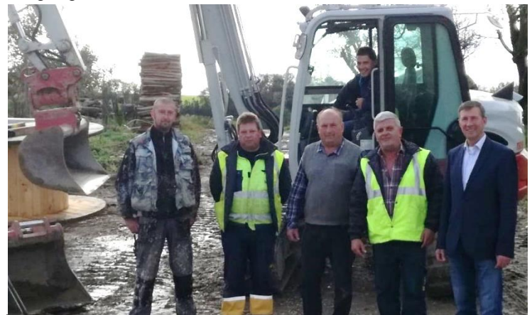
Baustellenbesichtigung in Egg durch Wasserwart Franz Leitner und Bgm. Roland Dietl (mit der Baupartie der ausführenden Firma Held & Francke).
