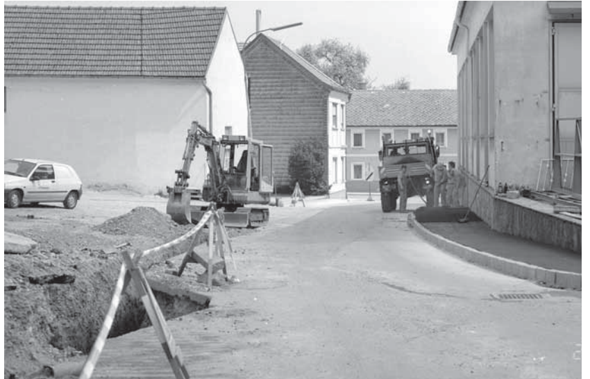
Künette für Einbauten in der Römerstraße und Asphaltierung des Gehsteiges entlang Pruckner-Schmied am 28. April 1993.
