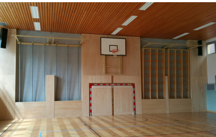
Turnhalle - Die Sanierung der Stirnseiten sowie der Hallenboden und die Beleuchtung sind abgeschlossen. Auch die Medientechnik wurde adaptiert.
