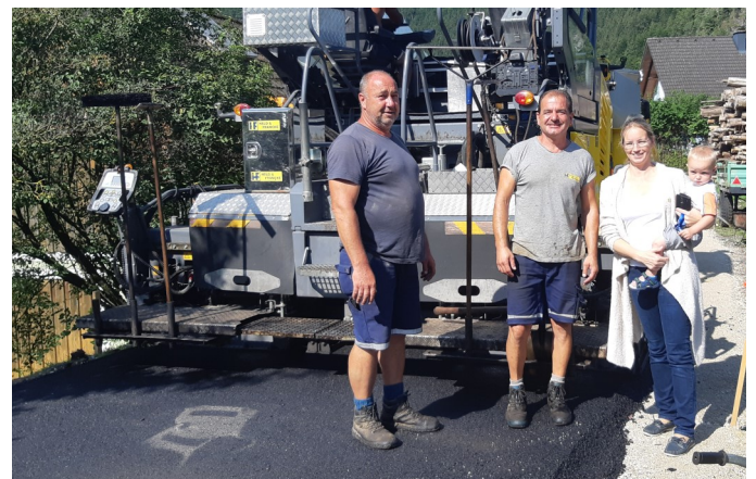
Krenlehenfeld - Letzte Woche wurde auch mit den Bankettarbeiten die Asphaltierung am Krenlehenfeld fertiggestellt.
