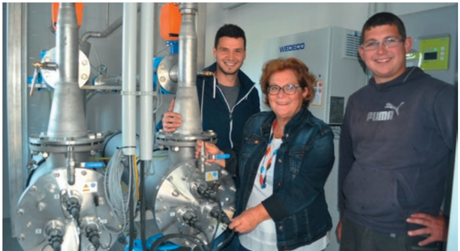
Der Brunnen in der Doislau wurde im September in Betrieb genommen. Seitdem versorgt er die Wasserversorgungsanlage mit bestem Wasser aus der Doislau.
