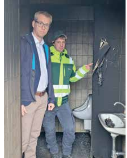
Bürgermeister Johannes Heuras und Bauhofleiter Erwin Hochauer sind bestürzt über den Vandalenakt.
