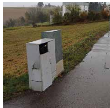
Glasfaserkasten Stadlweg beschädigt
