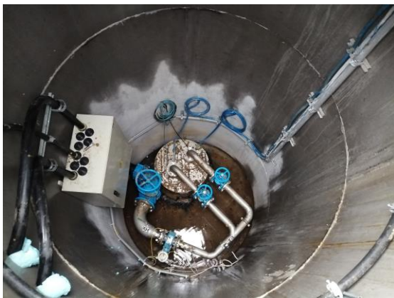
Abb. 3: Innenansicht, Bohrbrunnen „Au“
