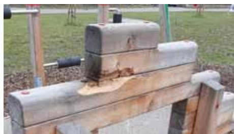
Vandalismus beim Motorikpark.
