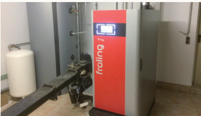
Heizkesseltausch Kindergarten Krenstetten
