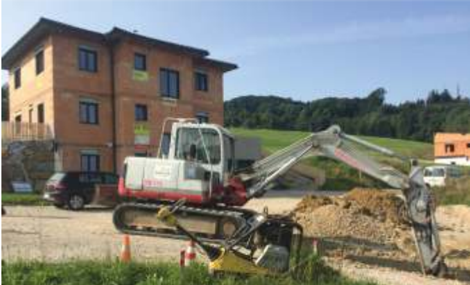
Die Siedlungsstraße in Hiesbach wurde mit den Einbauten wie Kanal, Wasser und Internet versehen.
